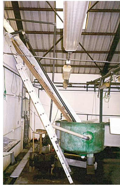
Photo 2 : vue de profil du pilote expérimental à la pente de 50°. Photo 2 : side view of the test installation at 50° slope.
