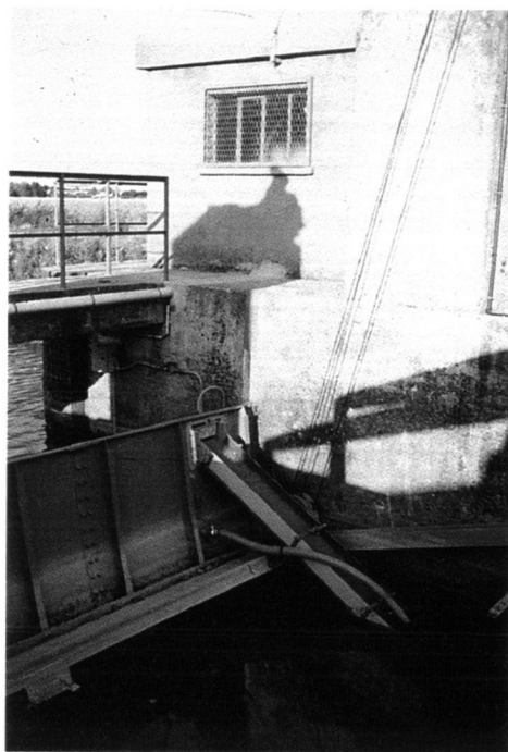
Photo 2 : Dispositif migratoire pour les civelles et anguilletes installé sur une vanne segment (cl. A. LEGAULT).
