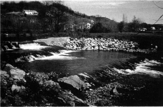
Photo 3 : Pré barrage en enrochements jointoyés au bitume de Zaldubia sur la Nivelles (Pyrénées-Atlantiques).
