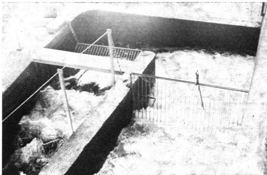
Photo 2 : Une partie de l'échelle Lachadenède, au barrage de Vichy. Les grilles de piégeage sont en place dans le bassin de repos.
