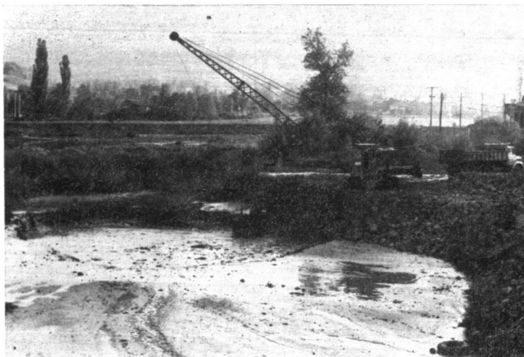
Photo 8 : CURAGE D'UN BASSIN DE DECANTATION d'eau de lavage, en bordure de Loire (Haute-Loire, été 1974).
