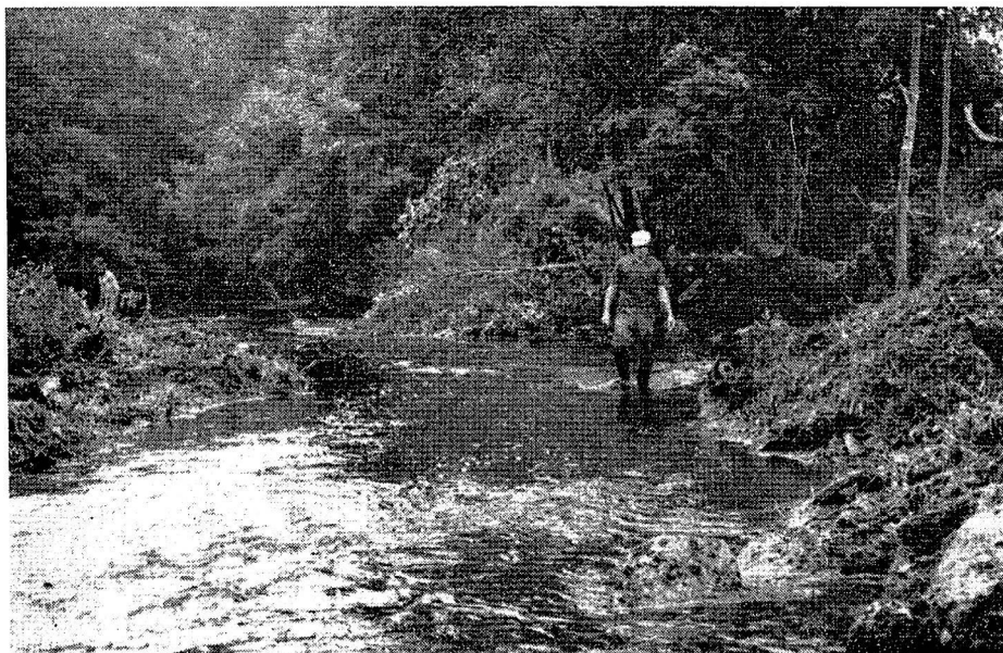
Fig. 6 — Travaux de nettoyage dans le Scorff entre le confluent avec le ruisseau de Kernec et le confluent avec le ruisseau de Penlan.
